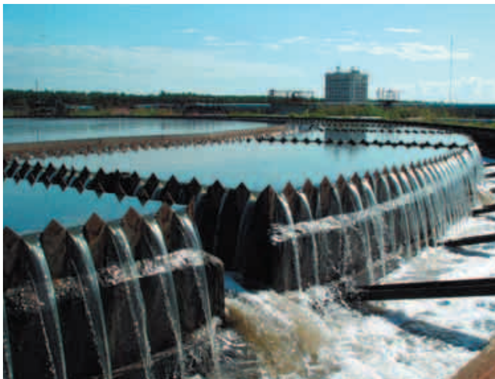
Pietarin keskeisen jätevedenpuhdistamon jälkiselkeytyksillä.
